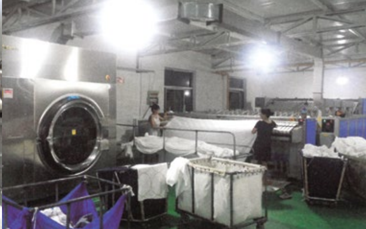
頂端的管道用於將燙平機的熱能回收再利用到烘乾機
