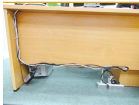
4.6 電掣開關和功能標籤及電線的整理（包括離地）
