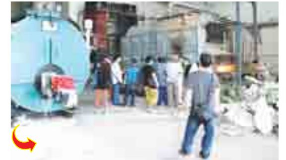
同業們正了解龍翔柏圖的鍋爐供氣系統中。
