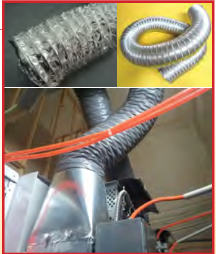
圖中為較易引起火警之排氣管，同業應盡量避免使用。
